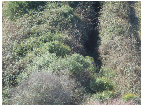
Particolare della vegetazione che soffoca l'alveo sotto la strada provinciale per Stintino.
