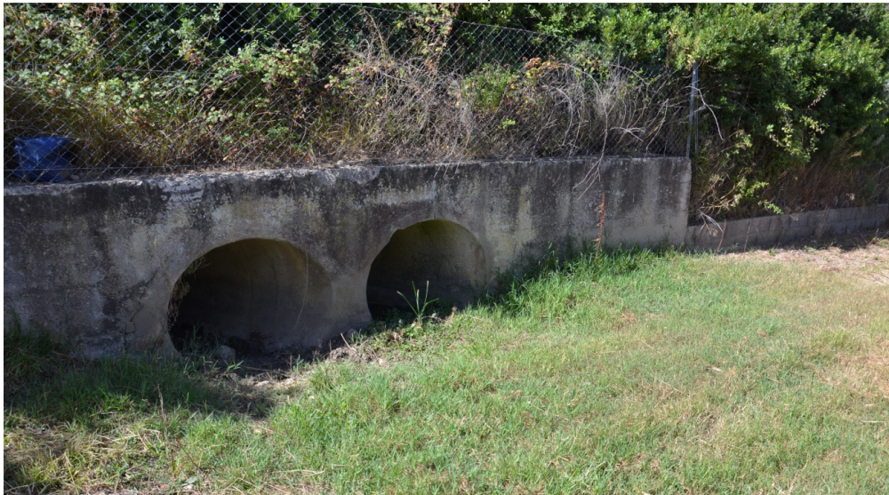
Il tombino, costituito da due tubolari di 100 cm di diametro, posto sotto il rilevato della provinciale, assolutamente insufficiente a garantire lo smaltimento delle portate oggetto del presente studio
