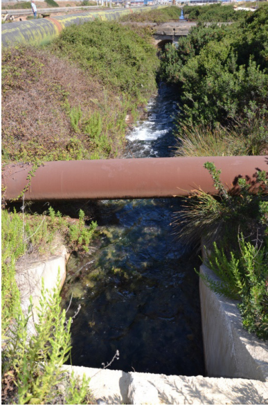
L'inizio dell'ultimo tratto dell'alveo prima dell'immissione nell'asta principale. È evidente la posizione del vecchio ponte che costituisce un ostacolo al deflusso delle piene
