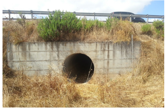
Il tombino posto in corrispondenza della intersezione dell'asta fluviale con la strada per Stintino.
