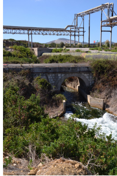
Il ponte della vecchia strada per Stintino, di sezione non adeguata.
