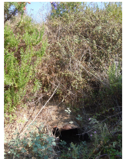
Un tombino posto in corrispondenza della sezione 40, assolutamente insufficiente e non considerato ai fini del modello He-Ras
