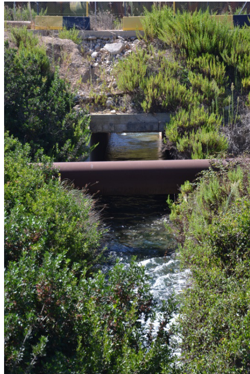
Il secondo ponte visto da valle, anch'esso con sezioni idonee al passaggio delle piene in studio. Può essere messo in crisi dalla presenza del ponte, da cui è effettuata la foto, ubicato immediatamente a valle.
