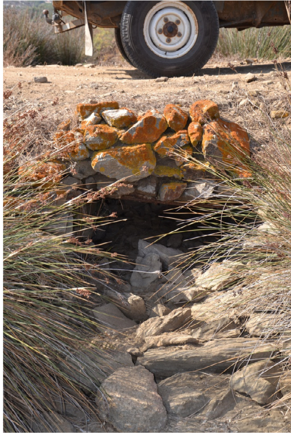
Il tombino estremamente artigianale sotto la strada che conduce alla diramazione di S. Maria
