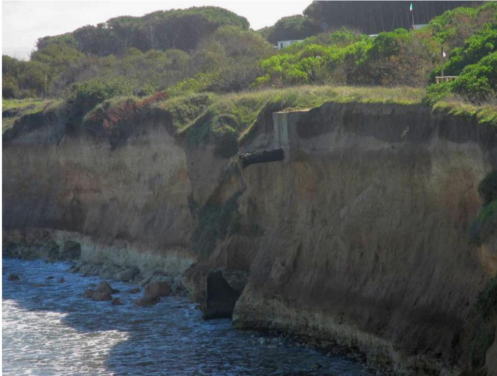
Figura 10. Particolare di un tratto di falesia in rapida evoluzione con movimenti franosi attivi
